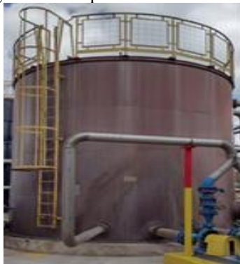
Figura 7 - Tanque de condicionamento
