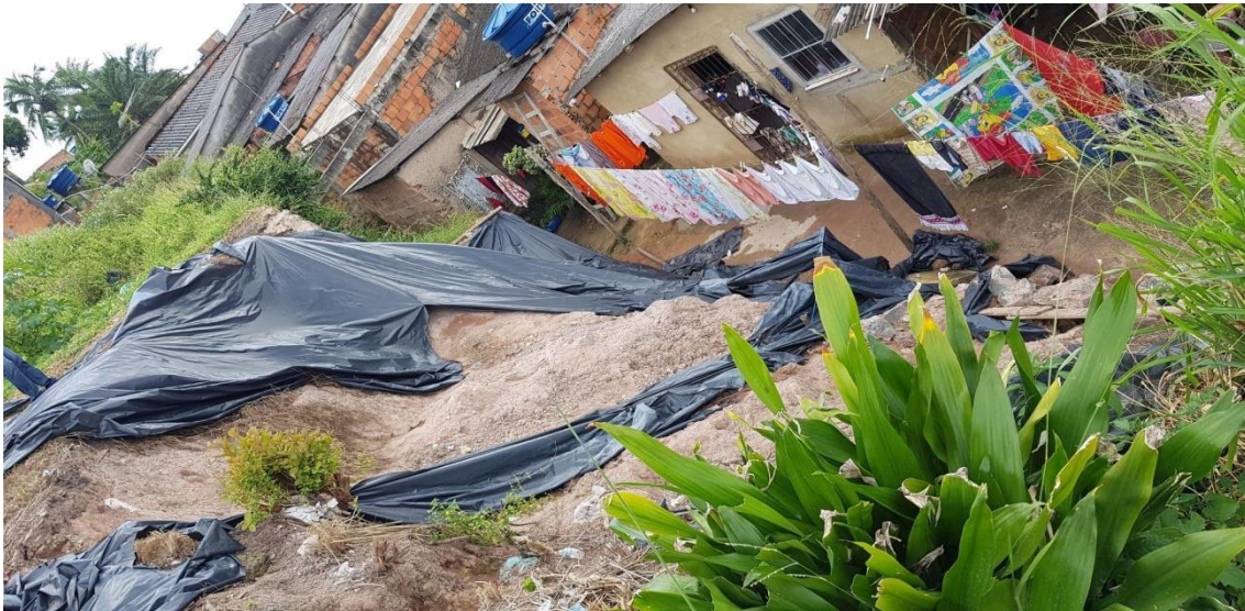
Figura 21. Talude em condição crítica da Rua 3.
