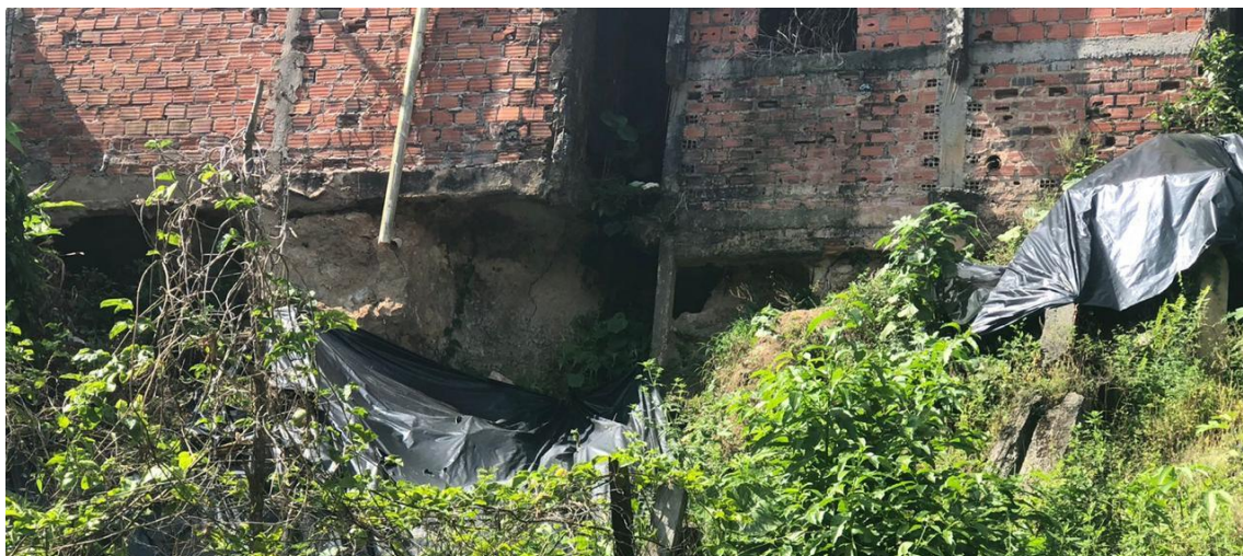
Figura 18. Imóveis em risco de contenção da Rua 1.
